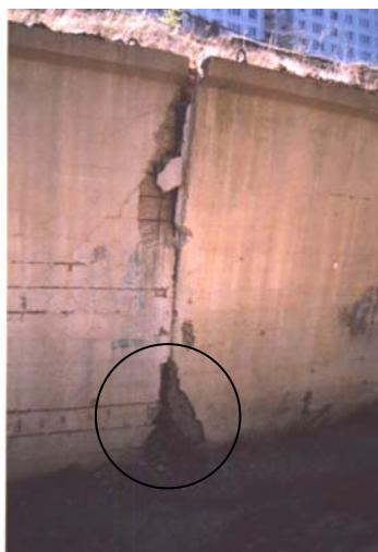
Разрушение подпорных стен (1998 – 2002г.г.)
