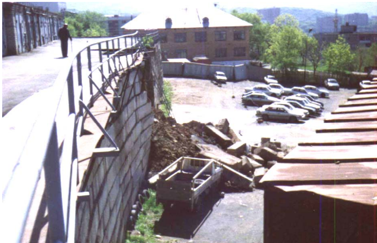
Примеры обрушений подпорных стен (1999г.)
